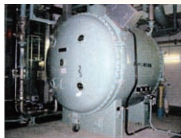
伏見水環境 保全センター オゾン発生装置
