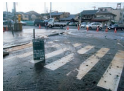
水道の漏水現場
