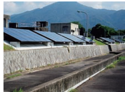
松ヶ崎浄水場の太陽光発電設備
