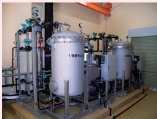
小野郷簡易水道浄水場（膜ろ過設備）
