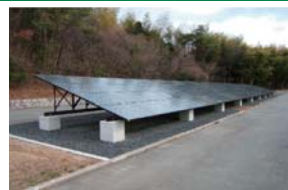
▲浄水場の太陽光発電設備
