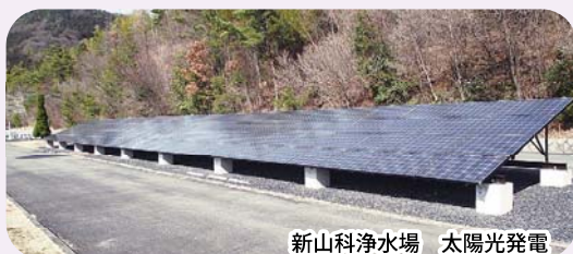
新山科浄水場 太陽光発電
