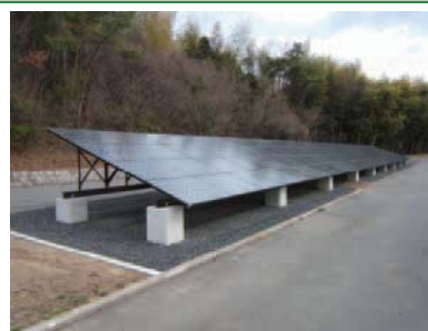
▲浄水場の太陽光発電設備
