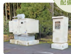
非常用発電設備
