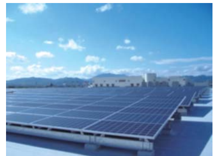
鳥羽水環境保全センターの大規模太陽光発電設備
