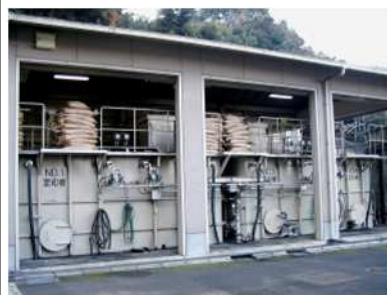
現在の粉末活性炭注入設備
