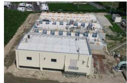
伏見水環境保全センター 分流系最初ちんでん池
