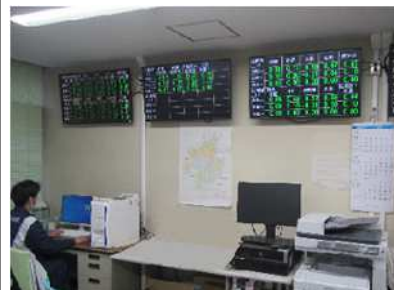
水質監視装置 監視画面
