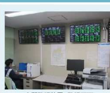
水質監視装置 監視画面
