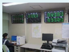
水質監視装置 監視画面
