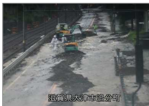
国道1号（京都・大津間）の大雨に伴う土砂流出による 通行停止状況（令和3年8月、大津市追分町付近） 【出典：滋賀国道事務所X】
