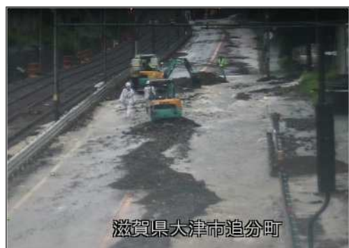
国道1号（京都・大津間）の大雨に伴う土砂流出による 通行通行止め状況（令和3年8月、大津市追分町付近） [出典：滋賀国道事務所X]
