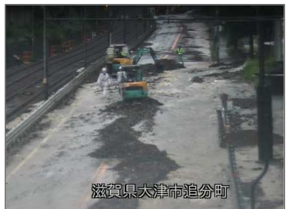
滋賀県大津市追分町 国道1号（京都・大津間）の被災・通行止め状況 (令和3年8月、大津市追分町付近) [出典：滋賀国道事務所X]
