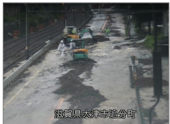
滋賀県大津市追分町 国道1号（京都・大津間）の被災・通行止め状況 (令和3年8月、大津市追分町付近) [出典：滋賀国道事務所X（旧 Twitter）]
