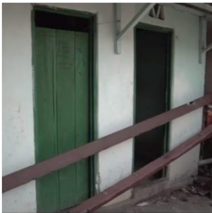
整備前のトイレ（損壊）
