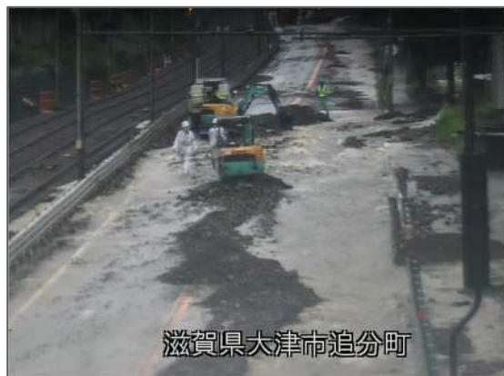
国道1号（京都・大津間）の被災・通行止め状況 (令和3年8月、大津市追分町付近) [出典：滋賀国道事務所 Twitter]
