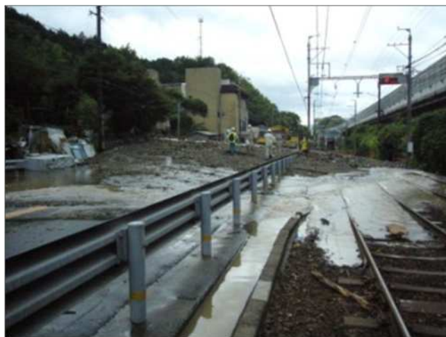
国道1号の被災状況（平成25年台風18号）
