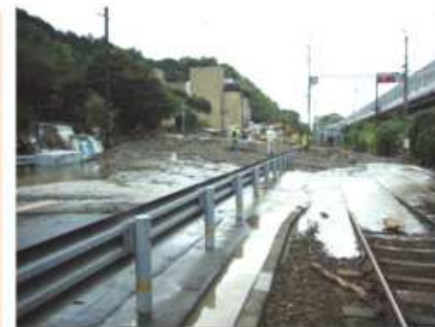
国道1号の被災状況（平成25年台風18号）
