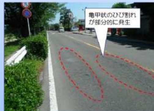
【舗装の劣化状況】
