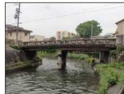
【老朽化した橋りょう】
