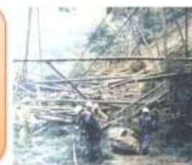
【土砂災害発生状況】
