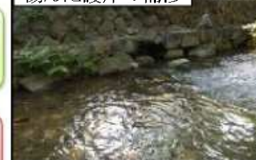
傷んだ護岸の補修
