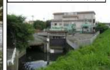
老朽化が進む排水機場
