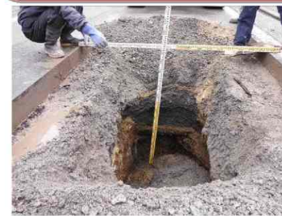
[路面下に発生した空洞の状況]
