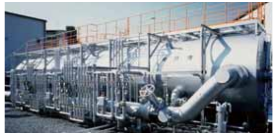
生ごみ等のバイオガス化施設
