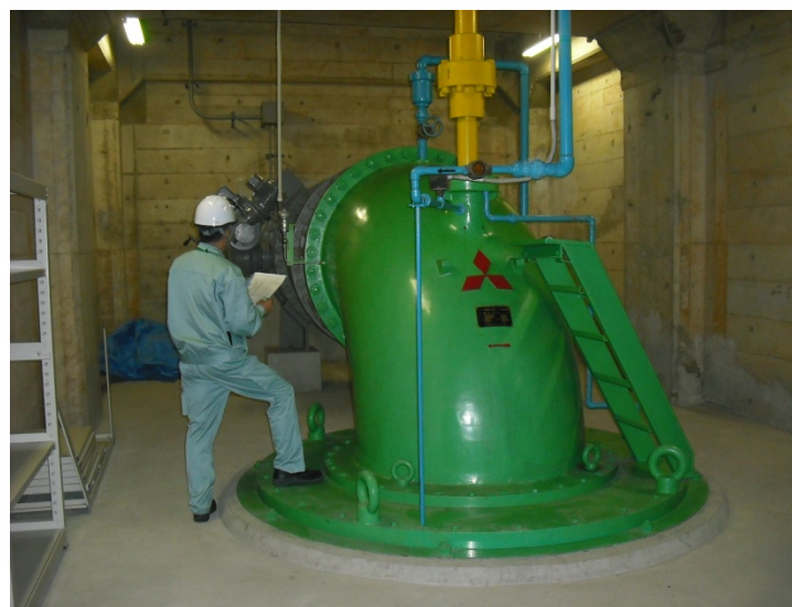
排水機場における ポンプ点検状況
