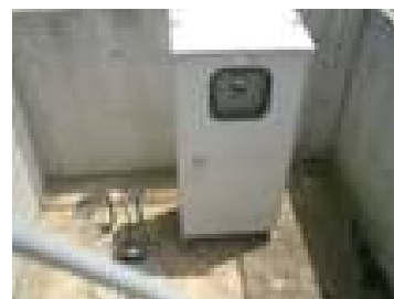
揚水井（地下型、半地下型）
