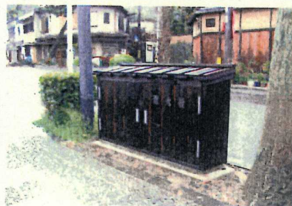
市民用消火栓
