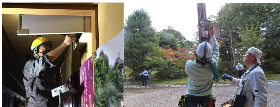
過去の「電気設備安全点検」の様子
