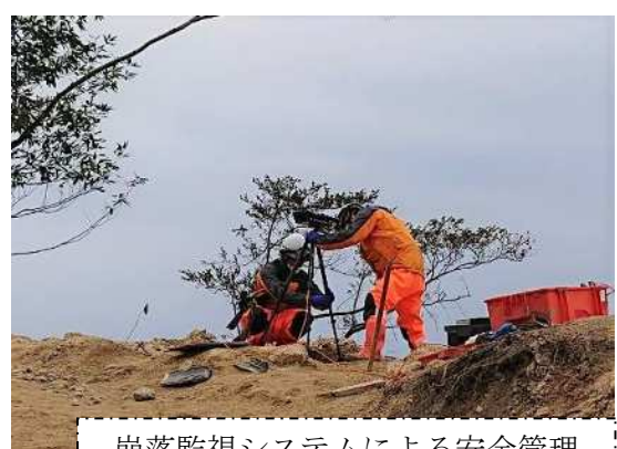
崩落監視システムによる安全管理
