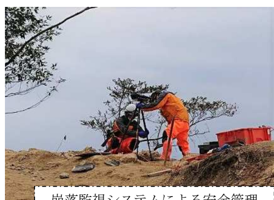
崩落監視システムによる安全管理
