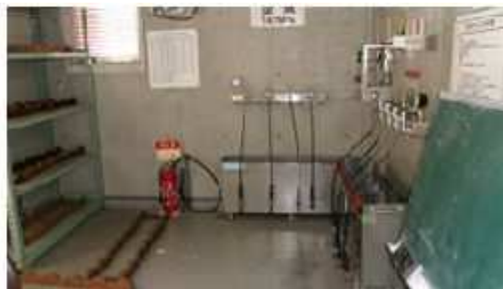
定置式空気製造施設
