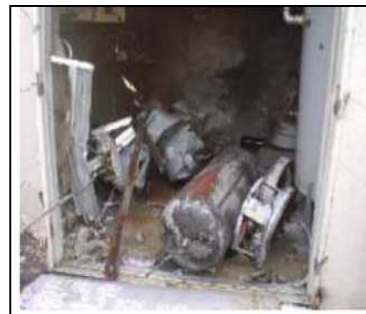
【京都市内の病院での爆発事故】 病院の倉庫内において医療用酸素を保管している容器が破裂・爆発したもの
