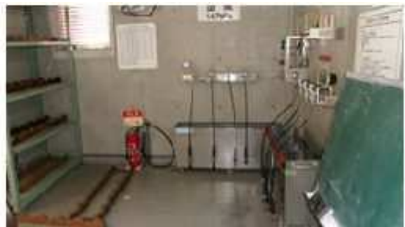
定置式空気製造施設
