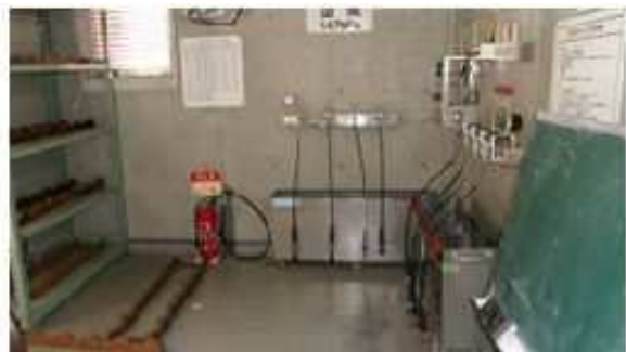
定置式空気製造施設
