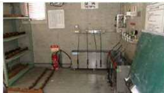
定置式空気製造施設
