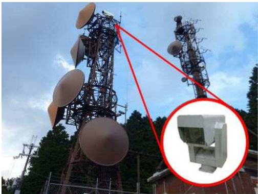
無線中継所及び高所カメラ
