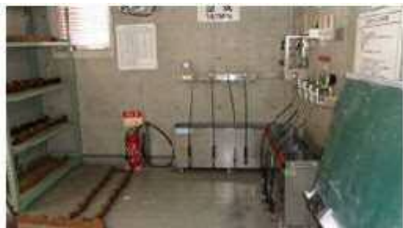
定置式空気製造施設
