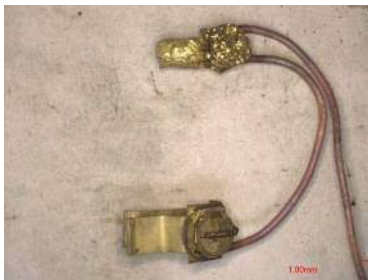
埋め込みコンセントの刃受けに溶断した箇所を確認
