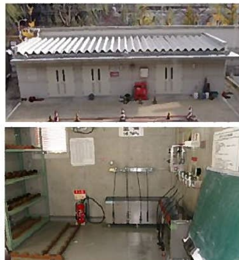
定置式空気製造施設
