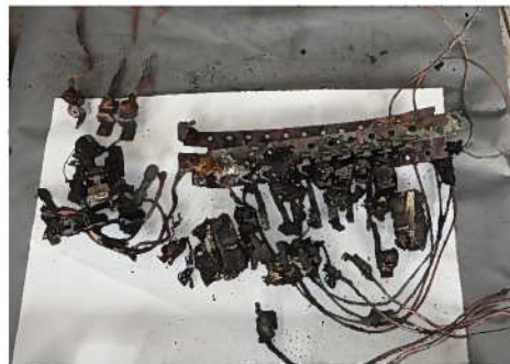
分電盤と配線の接続部に使用されるねじの緩みを確認
