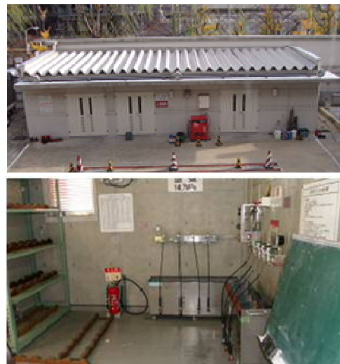
定置式空気製造施設
