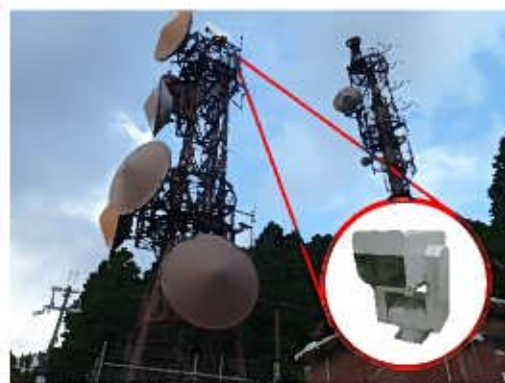
無線中継所及び高所カメラ
