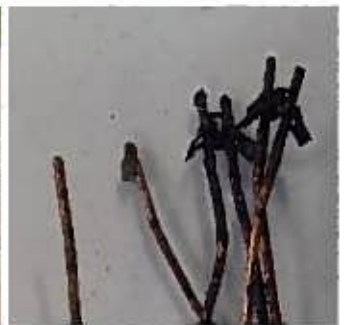
接続コネクタ部分に亜酸化銅を確認。
