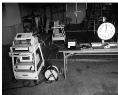
リチウムイオン蓄電池の測定
