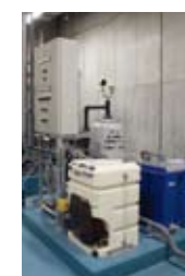
●消火訓練水の過装置
