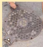
■下水処理水の活用
