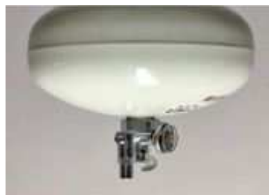
自動消火装置
