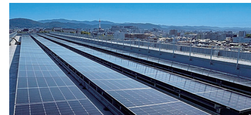
太陽光パネル
