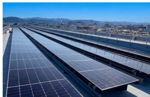
太陽光パネル
