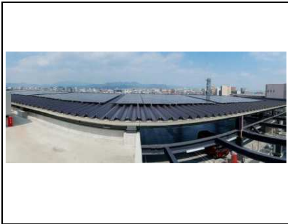
太陽光発電設備
