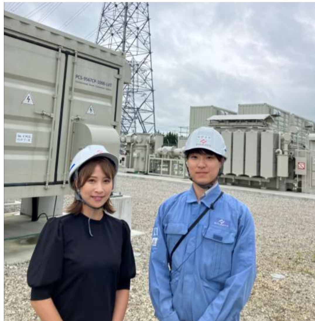
南早来変電所の系統用蓄電池
