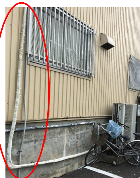
配管のテープが劣化し剥がれている
