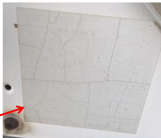
銘板の文字が読めない程劣化
