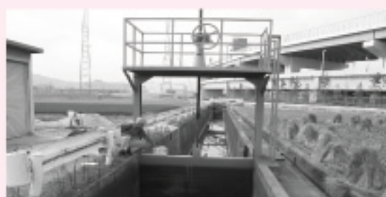
農業用取水施設（鋼製の水門）
