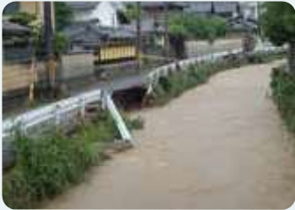
護岸・ガードレール損傷の様子
