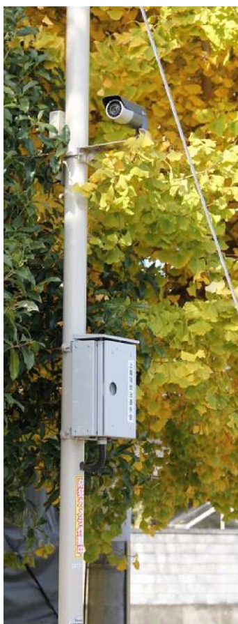
防犯カメラの設置
